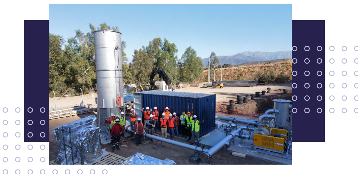
Torchère sur CET avec container de traitement du gaz ©Micr'Eau
